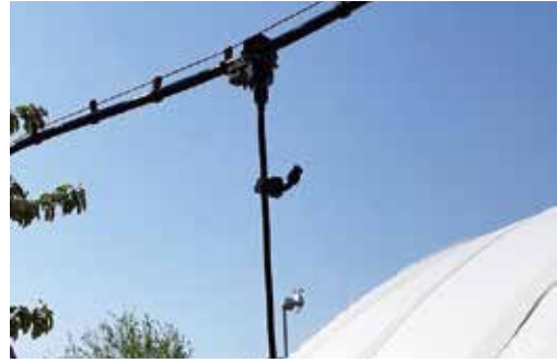
수직 4단 평지 설치 현황 [그림 18] 라인4 수직 노즐
