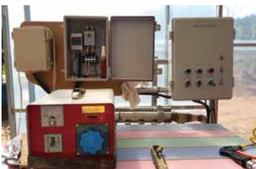
220V 10kW 전력 조절부 및 컨트롤러
